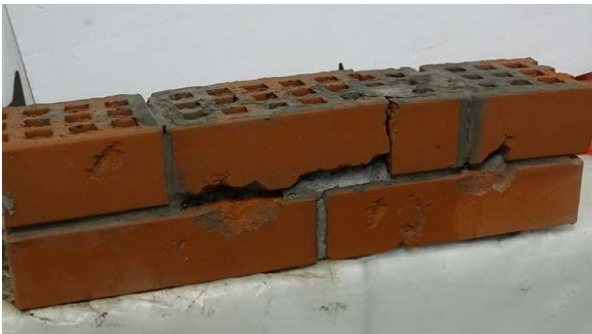
Рис. 1 Вид поврежденного участка кирпичной стены.
